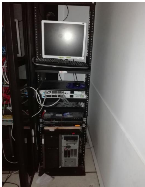
Figura 19. DATA CENTER – Data Center de la Delegación Provincial Electoral de Orellana
